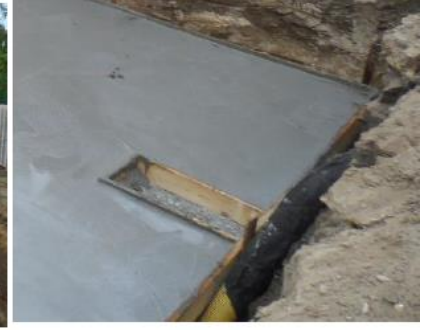
Auslass für den Bodenablauf
